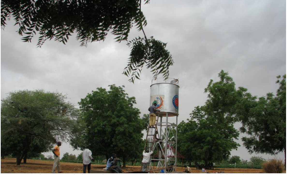
Resim 8 Proje çerçevesinde yapılan ve güneş enerjisi ile çalışan 10 tonluk su deposu
